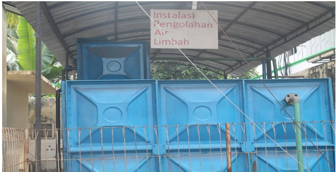
INSTALASI PENGOLAHAN AIR LIMBAH
